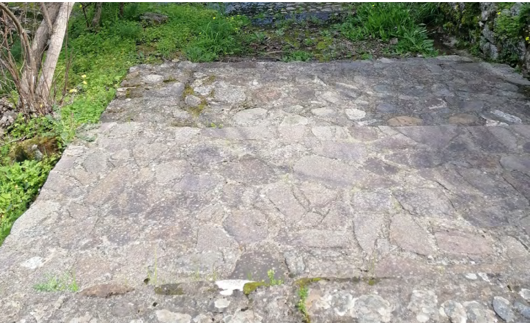
Foto 77 – Pavimentazione della scalinata adiacente alla Fontana della Rocca, in frammenti di pietra e cemento
