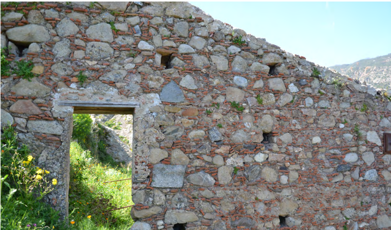
Foto 80 – Intervento improprio su architravi e creste murarie
