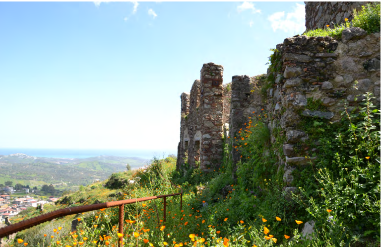
Foto 81 – Ruderi a rischio crollo, privi di interventi
