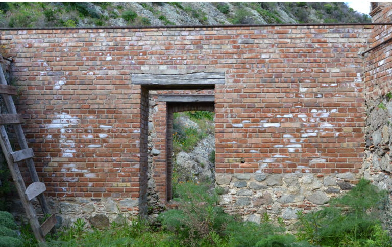
Foto 75 – Muratura con presenza di efflorescenze
