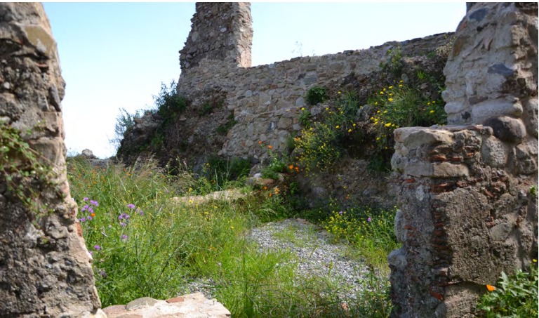
Foto 79 – Intervento improprio sulle creste murarie
